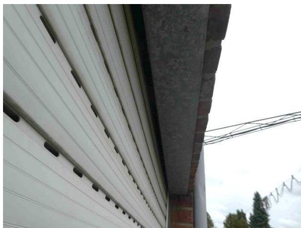
Foto 14: ... die einen Spalt geringer Breite (ca. 1 cm) aufweisen
