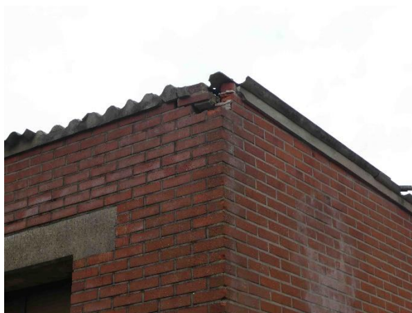
Foto 8: ... mit Schadstelle am Dachübergang (freier Zuflug in die Halle möglich)
